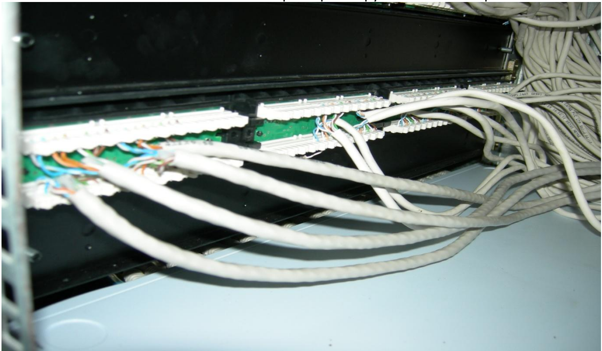
Кросс панель RJ45. Облочка срезана. Свивка пар нарушена. Кабели висят в воздухе. Маркировка кабелей отсутствует.
